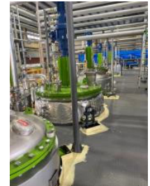
写真5 プラント内部
