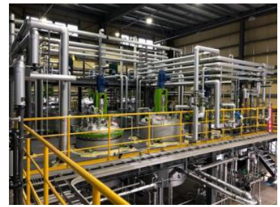
写真3 プラント内部
