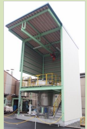
高品位尿素水溶液設備
