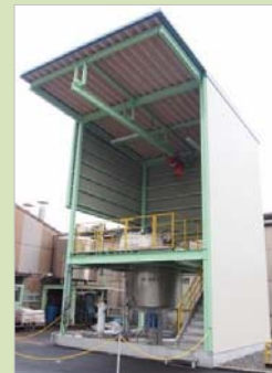
（高品位尿素水溶液新設備）
